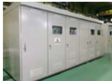
高圧受電設備
